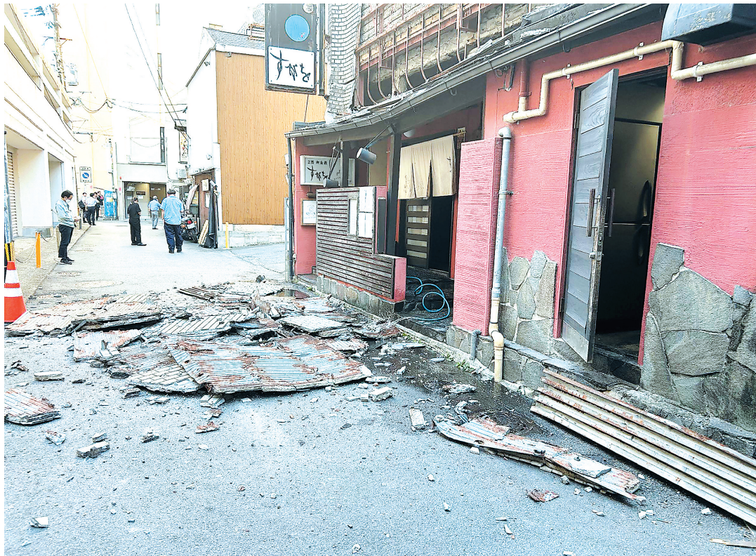
28日,日本熊本县,一家商店的外墙在地震中倒塌。视觉中国/图
