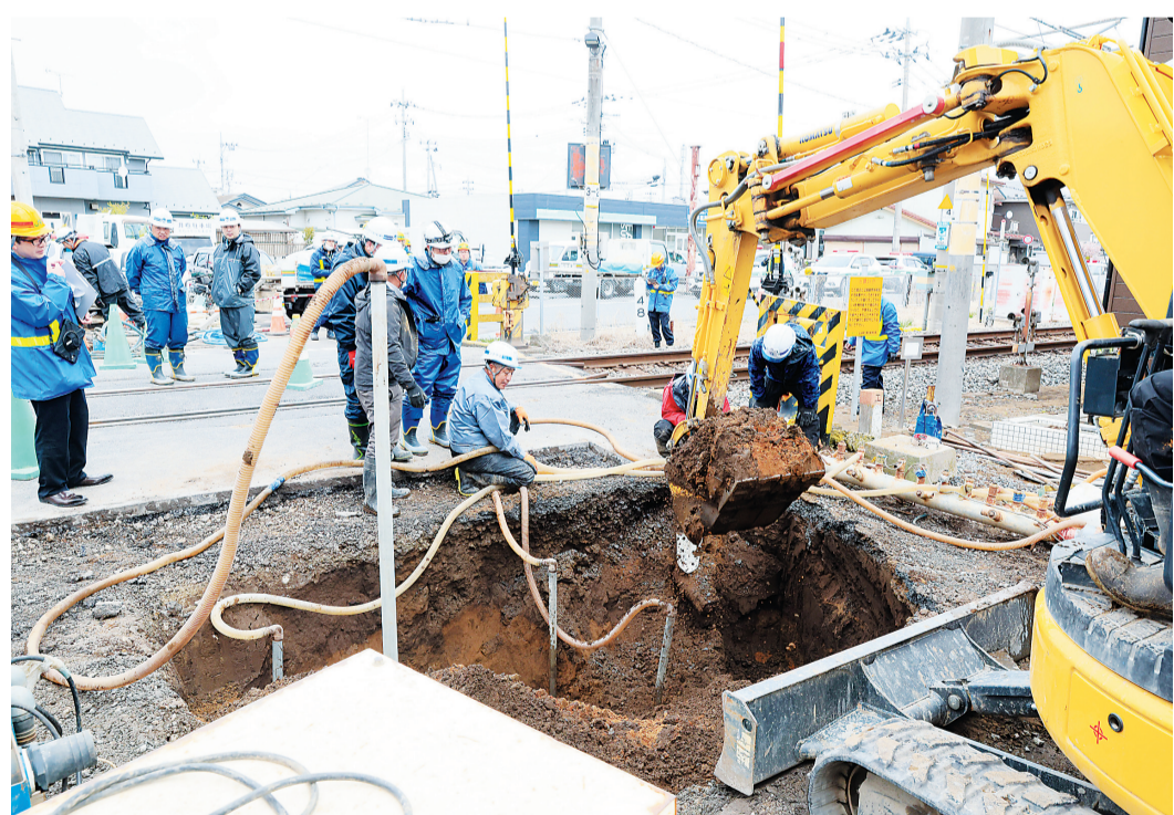
21日，日本宫城县石卷市，因地震引发漏水导致道路塌陷。视觉中国/图
